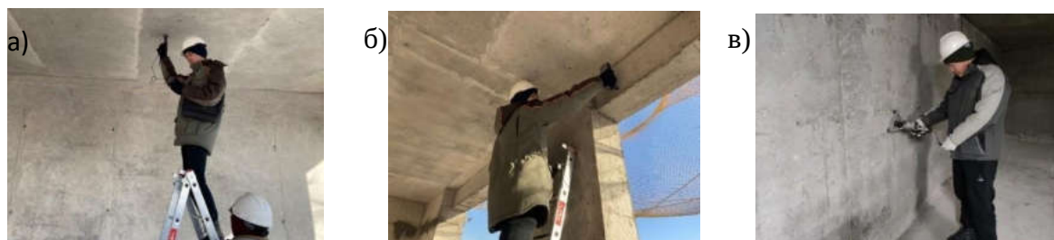
а) прибором ИПС-МГ4; б) прибором УКС-МГ4; в) прибором ПОС-50МГ4 Рисунок 3 – Определение прочности бетона неразрушающими методами [1], [2].
