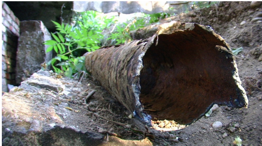
1 сурет: Құбыр коррозиясы
